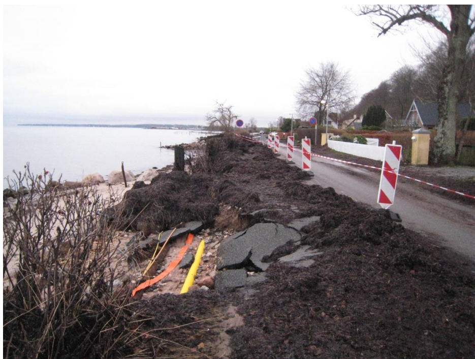
Figur 1.1: Erosion af GI Strandvej under stormen Bodil 5-6. december 2013. Det gule rør viser en gasledning og det orange kabel viser el-ledning, der var eksponeret for bølgepåvirkning under stormen.
